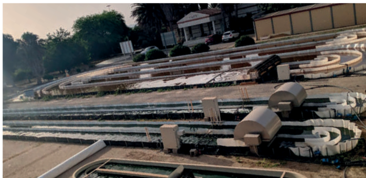
FIGURA 9. Reactores raceway . Abajo reactores de 80 m 2 , arriba reactor de 600 m 2 . Los dos reactores de abajo están alimentados con agua residual y purines de cerdo cada uno.
